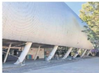
Las fachadas de las escuelas se encuentran en mal estado, debido a la falta de mantenimiento.
