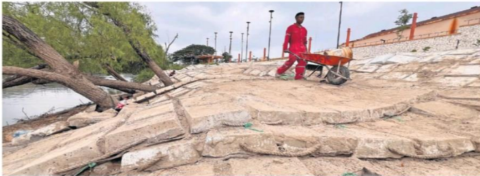
El malecón Carlos A. Madrazo de Villahermosa, Tabasco, se empezó a reconstruir en 2022 y, aunque todavía no ha sido terminado, ya presenta deficiencias.
