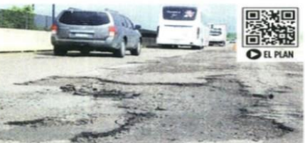
Las obras del Tren Maya dejaron casi mil kilómetros de carreteras dañadas, según datos de la SICT.
