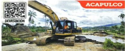
La carretera que comunica a Coyuca de Benitez con la Costa Grande, se encuentra dañada.
