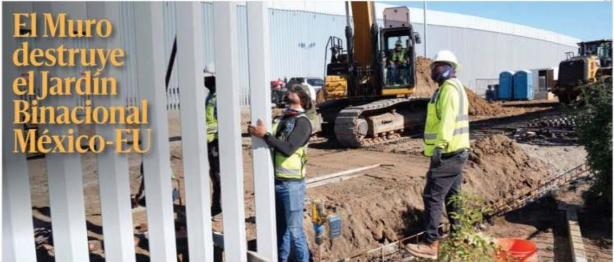
El Jardín Binacional, en la línea fronteriza entre Tijuana y San Diego, quedó reducido a casi nada luego de que obreros y maquinaria pesada le pasaron por encima para continuar la construcción del muro de nueve metros de alto ordenado por expresidente Donald Trump. PAG 17
