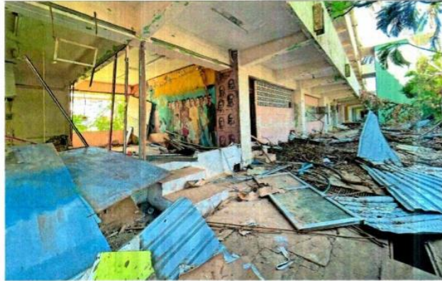
Escuelas como la Federal 1, en Acapulco, resultaron severamente dañadas por el huracán del 25 de octubre. Aún permanecen los escombros en las aulas y no hay todavía plan de restauración ni fecha de regreso a clases.
